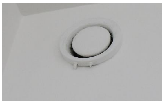
Photo 3 : Bouche d'extraction en pièce humide
