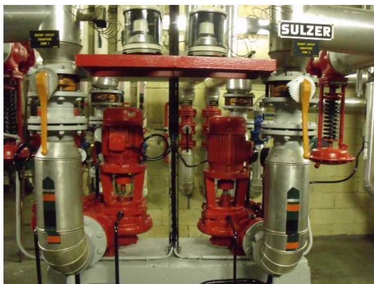
Photo 7 : Pompes de circulation
