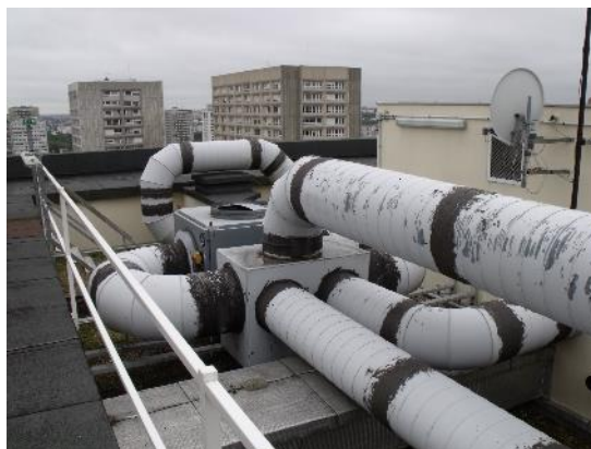
Photo 5 : Gains et caisson de ventilation en toiture
