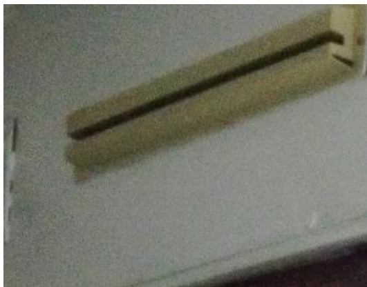
Photo 4 : Bouche d'entrée d'air en pièce de vie, située dans les coffres de volets roulants
