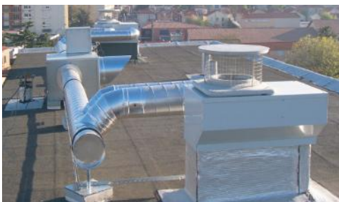
Caissons d'extraction de VMC
